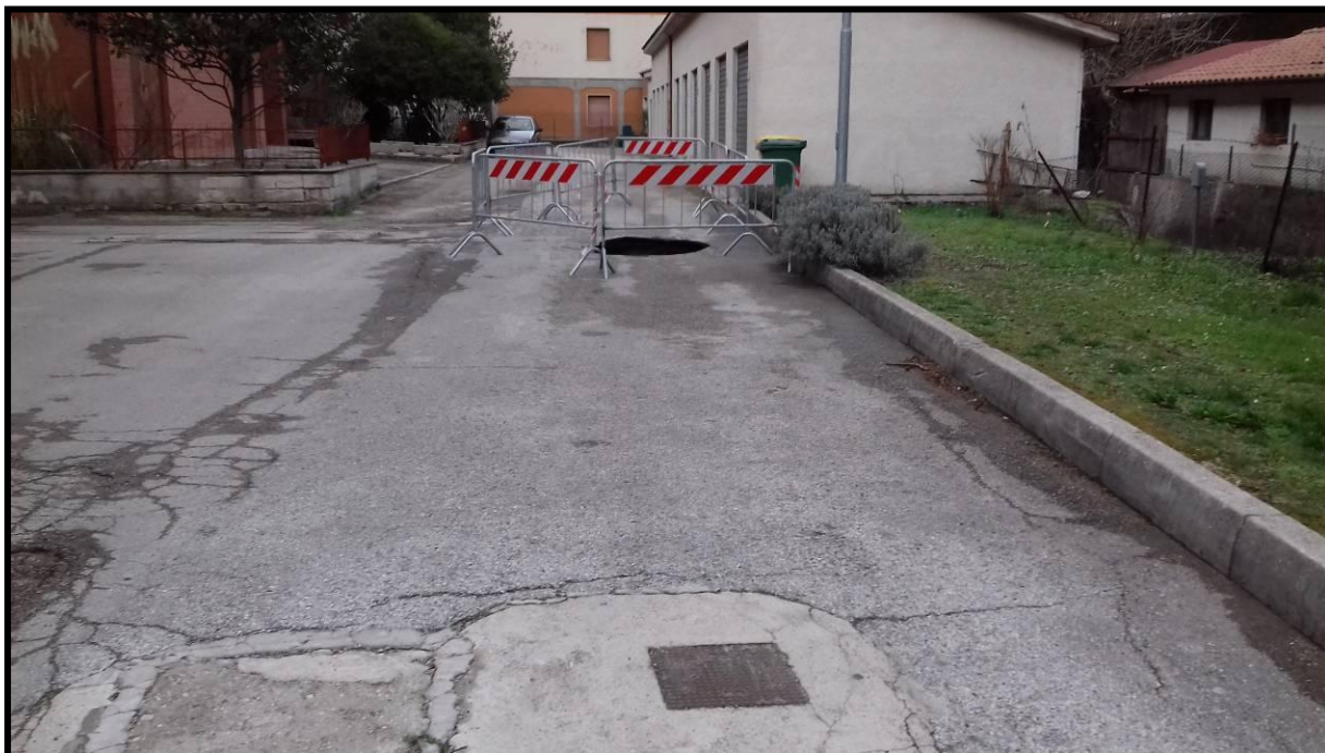
Figura 23 Area in subsidenza con lo sprofondamento localizzato.
