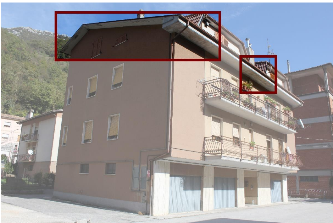
30) Inadeguato smaltimento delle acque meteoriche (cornicioni) con scarsa manutenzione.
