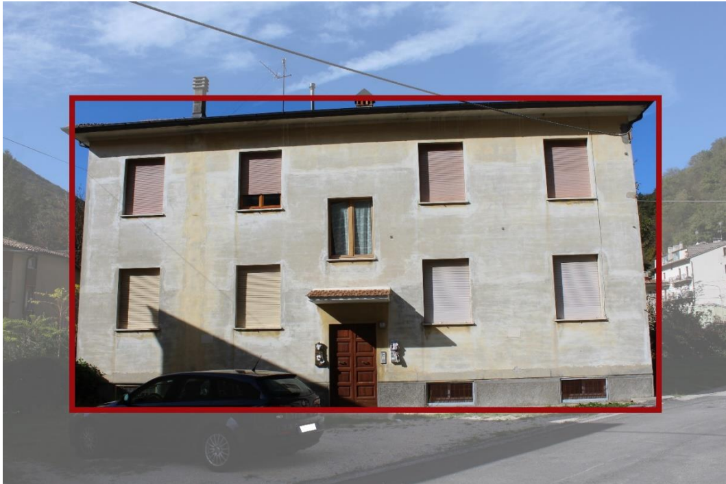
5) Scarsa manutenzione ed inadeguate disposizioni impiantistiche (canna fumaria inglobata nello spessore murario).
