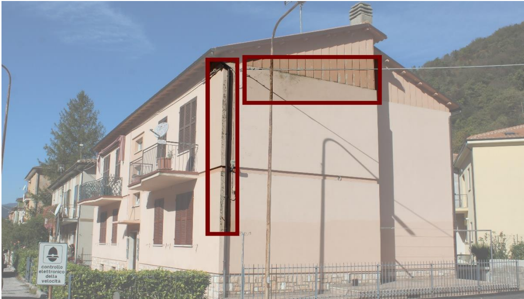
1) Umidità di condensa con ammaloramento dell'intonaco ed inadeguate disposizioni impiantistiche (degrado in corrispondenza del pluviale).
