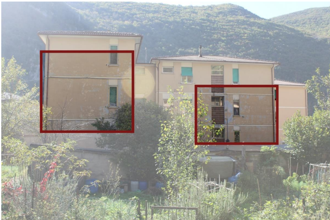
10) Umidità di condensa con ammaloramento dell'intonaco ed inadeguate disposizioni impiantistiche.
