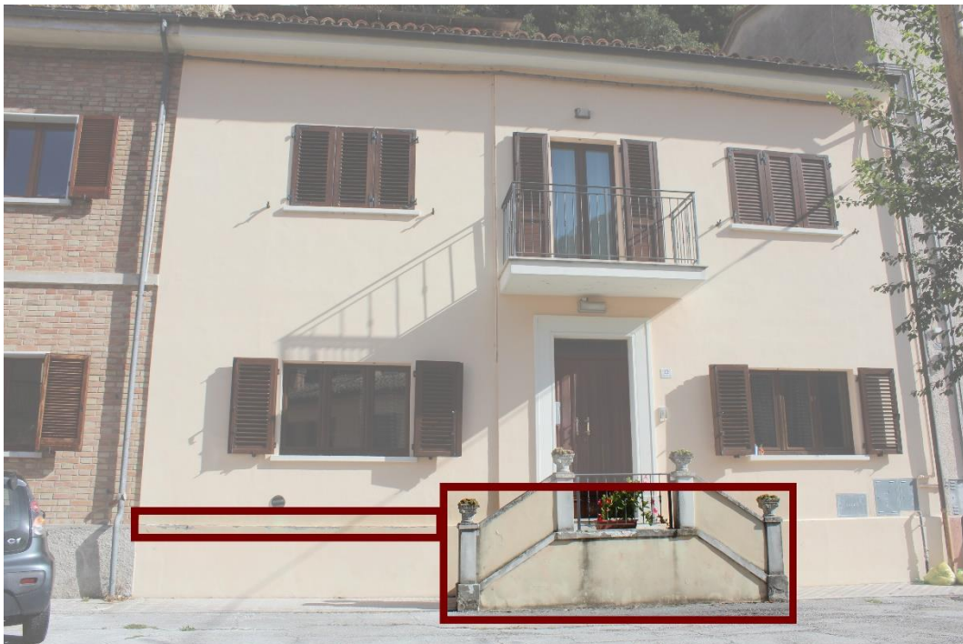
4) Inadeguato smaltimento delle acque meteoriche e scarsa manutenzione.
