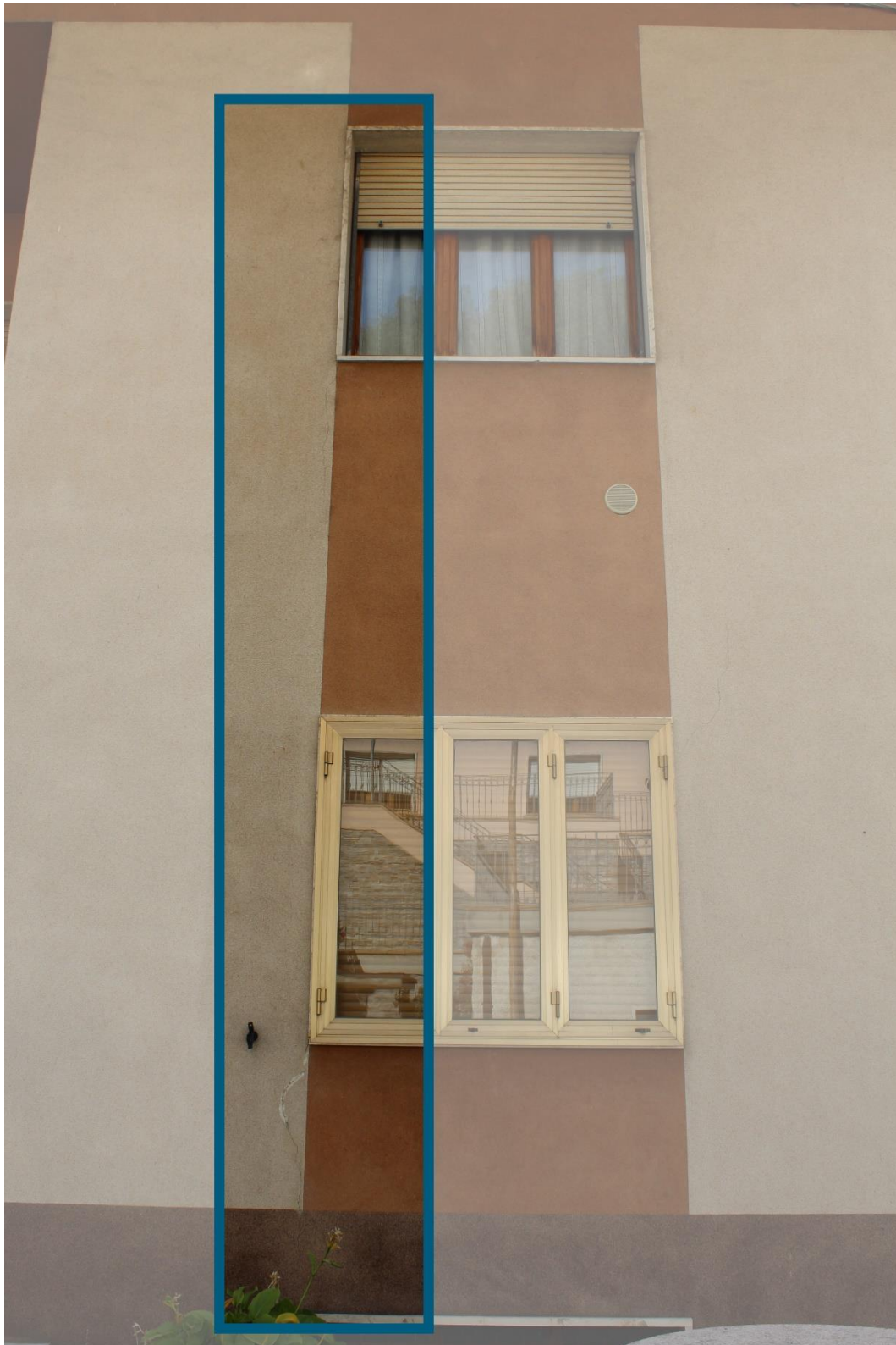
18) Lesione da traslazione verticale in un muro con aperture (percorsi che offrono la minore resistenza alla rottura).
