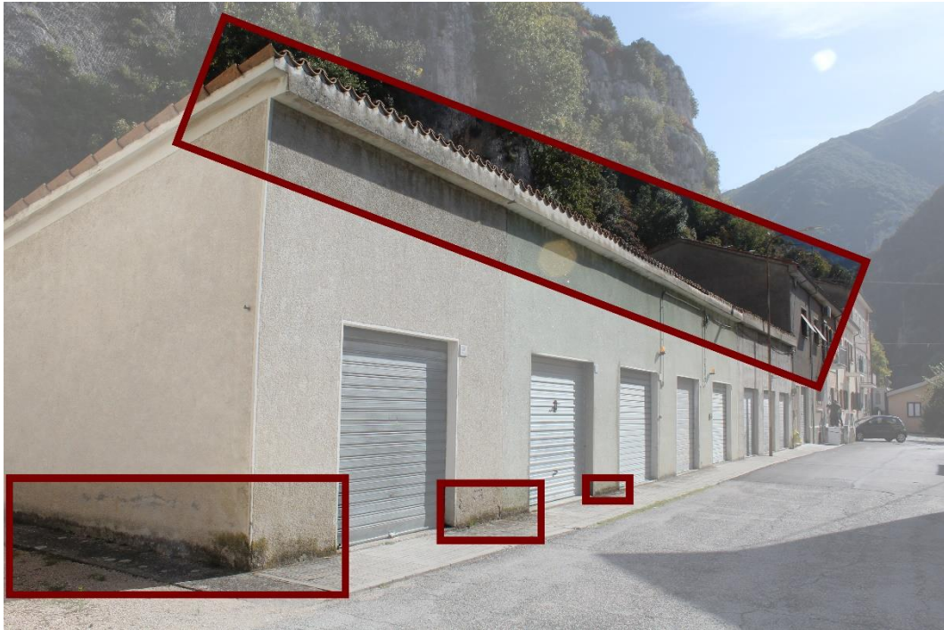
9) Umidità di risalita dal terreno e scarsa manutenzione.
