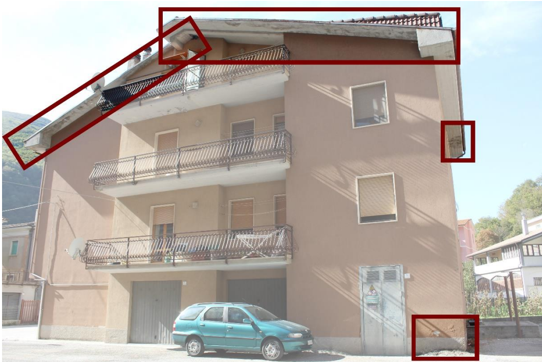
29) Inadeguato smaltimento delle acque meteoriche (cornicioni) con scarsa manutenzione e umidità di risalita dal terreno con cristallizzazione di sali.
