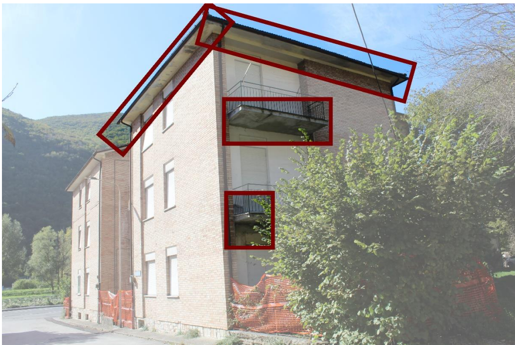
17) Inadeguato smaltimento delle acque meteoriche (balconi e cornicioni).
