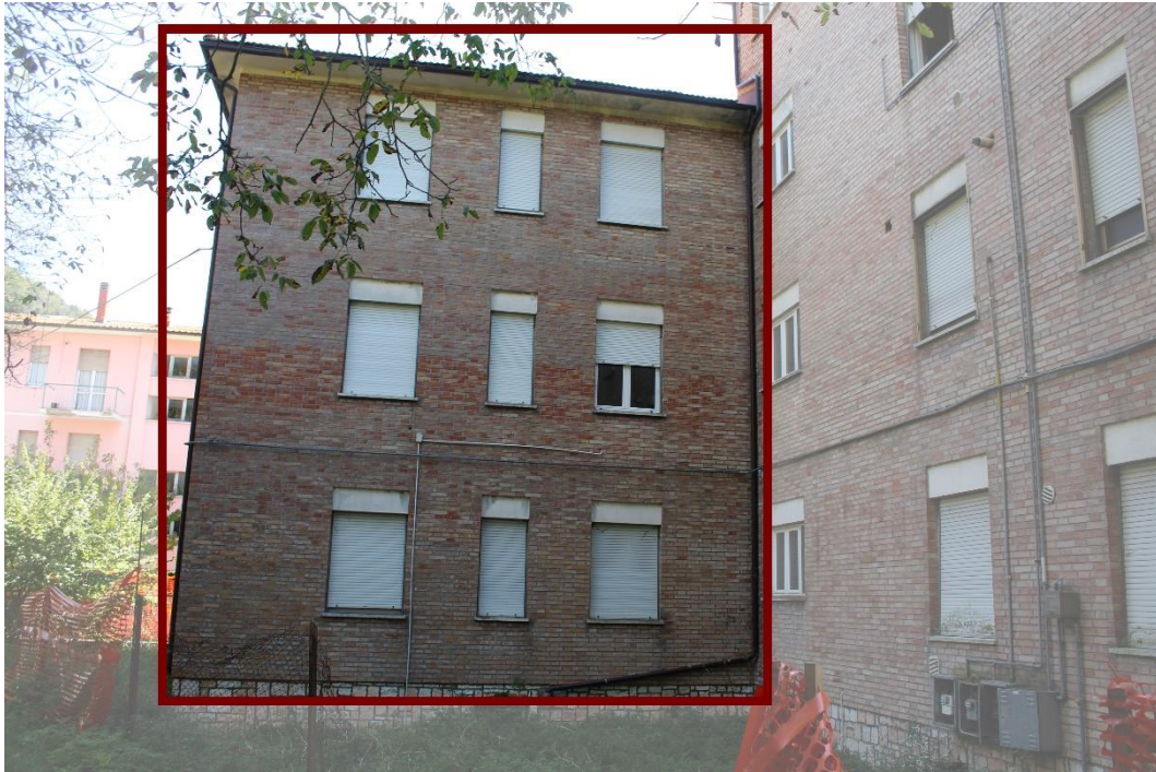
18) Alterazioni cromatiche della tessitura muraria ed inadeguato smaltimento delle acque meteoriche (cornicioni).
