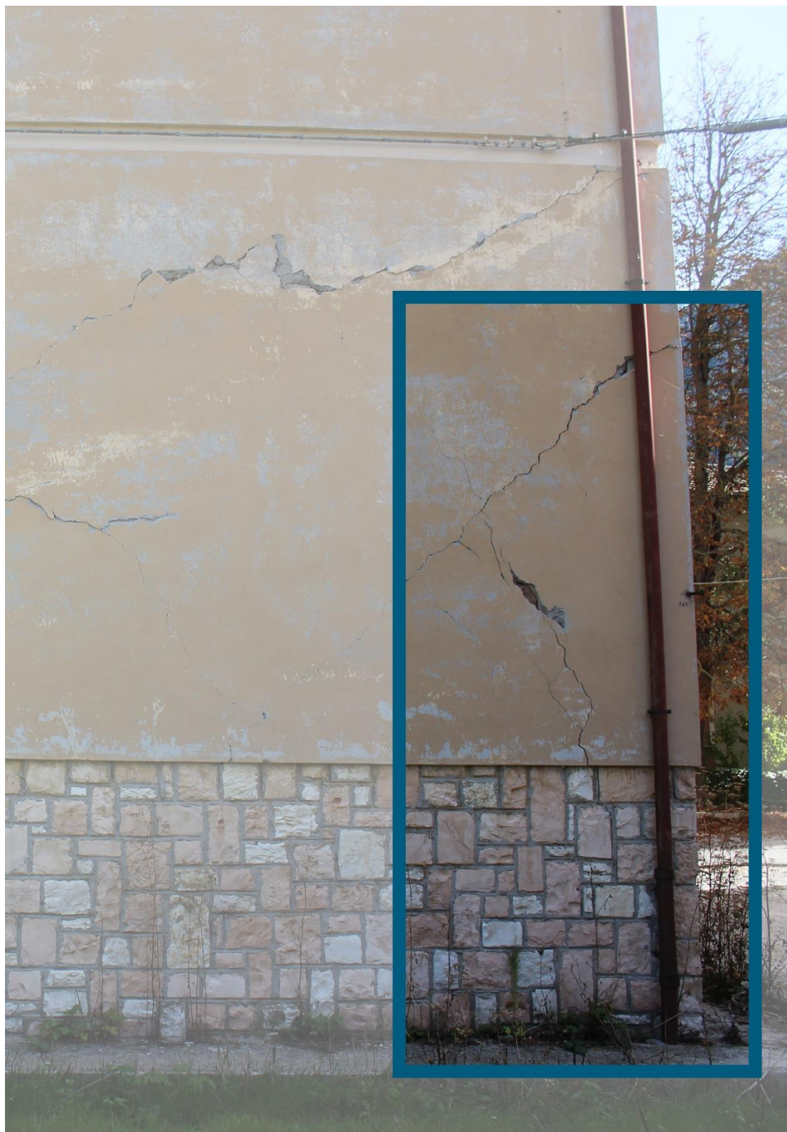
20) Lesione da rotazione derivante da elevati cedimenti differenziali fondali (vistoso fuoripiombo).
