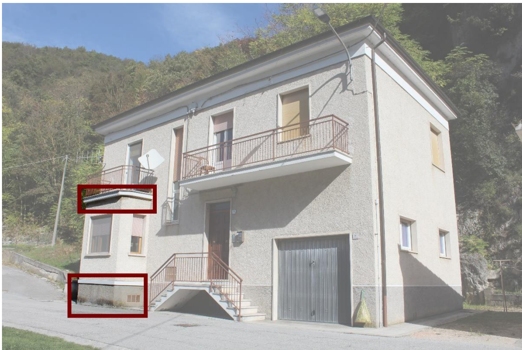
8) Umidità di risalita dal terreno e inadeguato smaltimento delle acque meteoriche (balcone).
