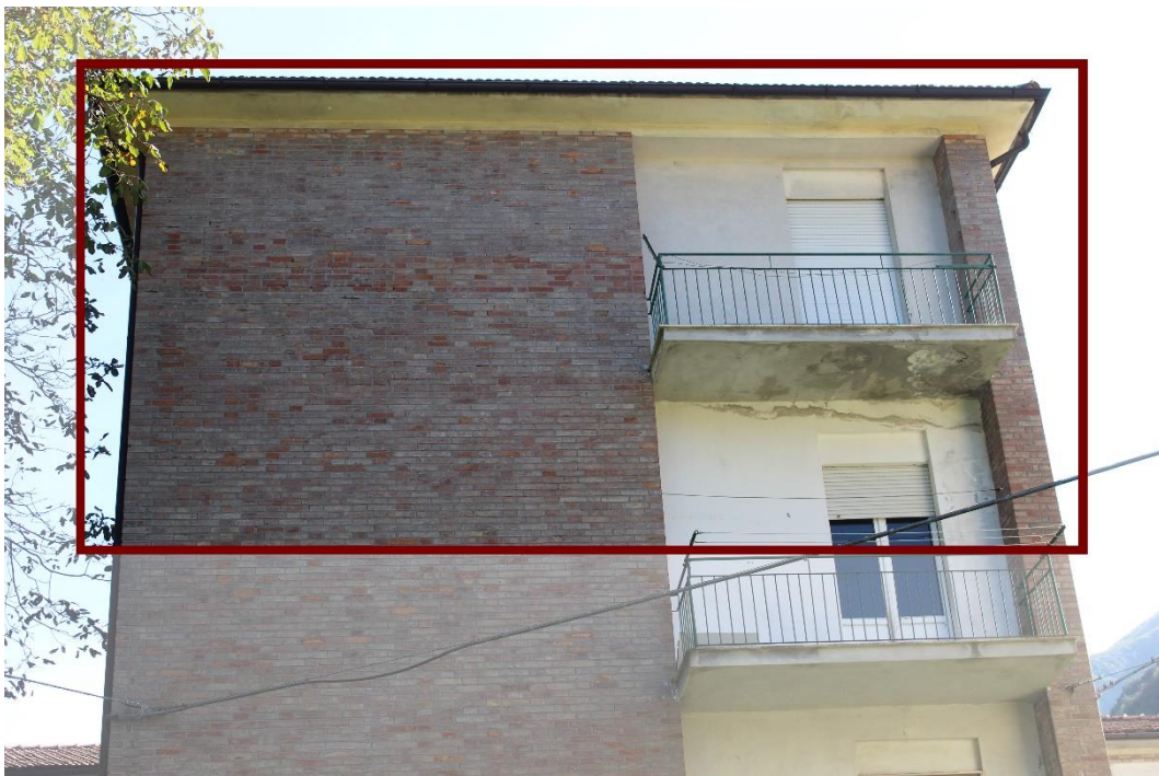
19) Alterazioni cromatiche della tessitura muraria ed inadeguato smaltimento delle acque meteoriche (balconi e cornicioni).
