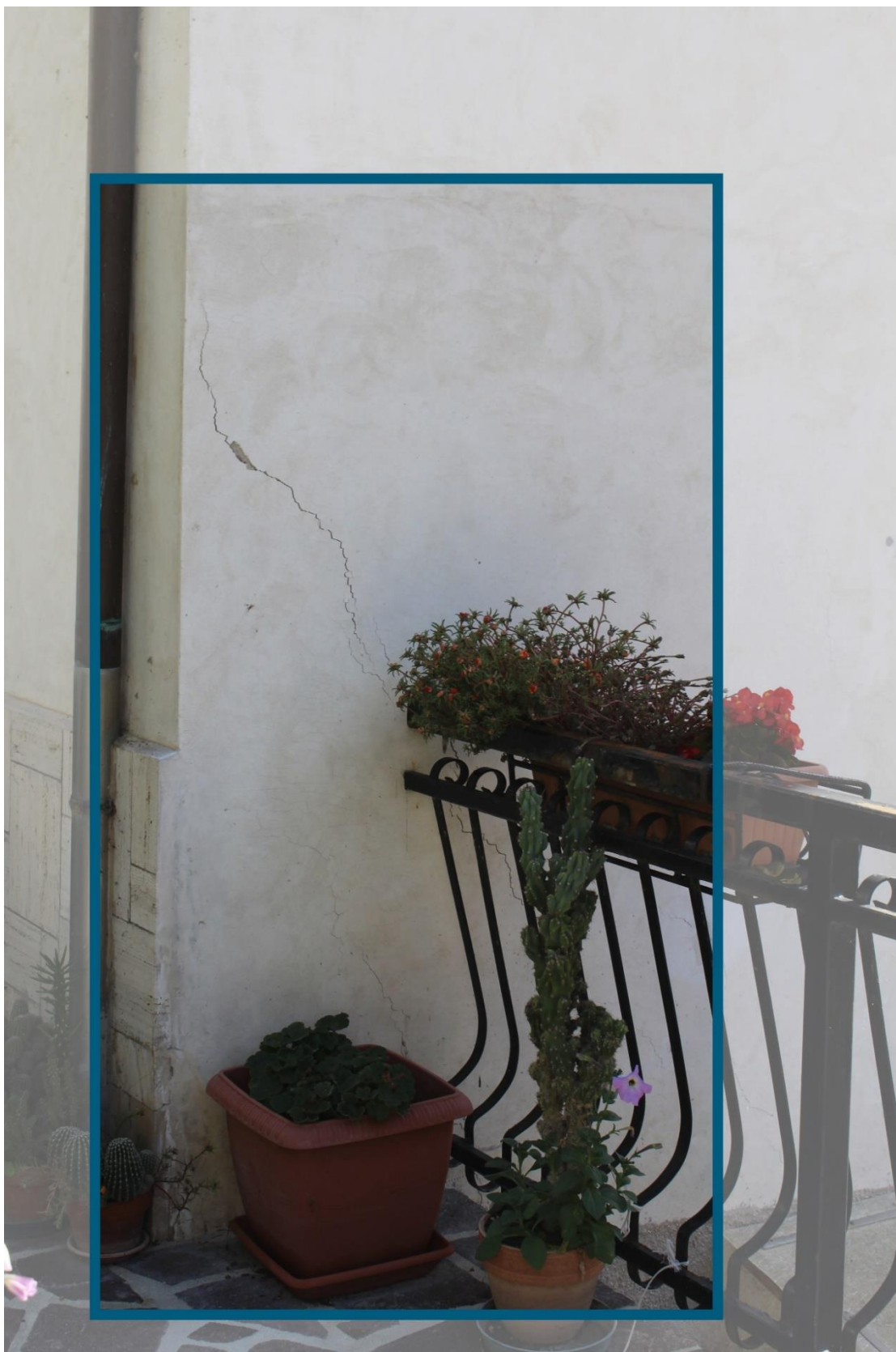
2) Lesione da traslazione verticale terminale relativa al cedimento fondale a valle della facciata.
