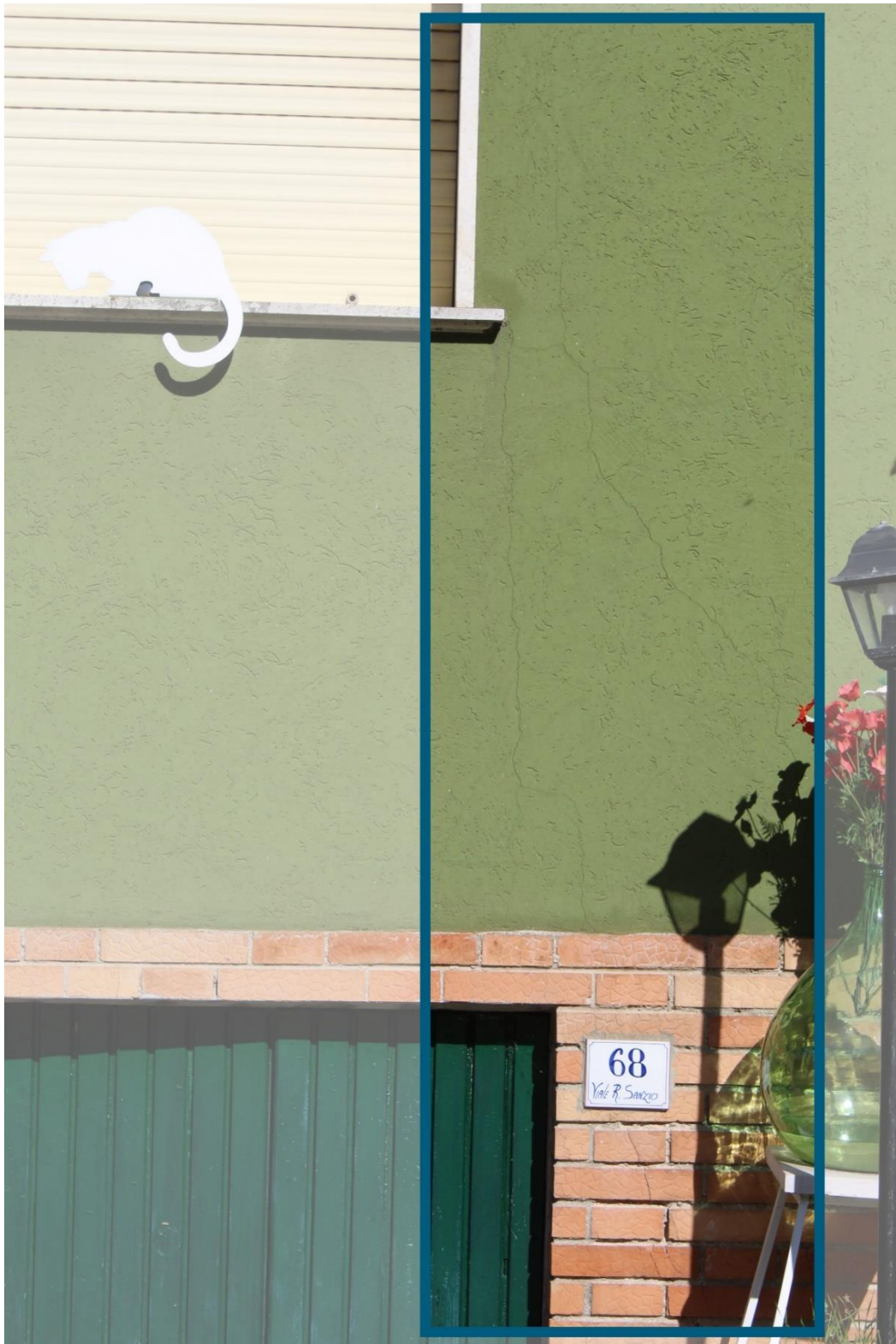
13) Lesione da traslazione verticale in un muro con aperture (percorsi che offrono la minore resistenza alla rottura).
