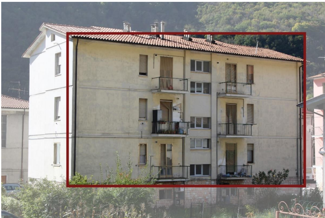
15) Umidità di condensa con ammaloramento dell'intonaco.
