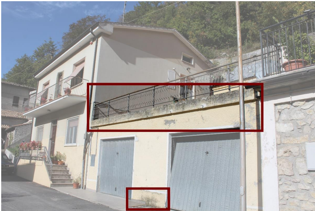
16) Inadeguato smaltimento delle acque meteoriche ed umidità di risalita.
