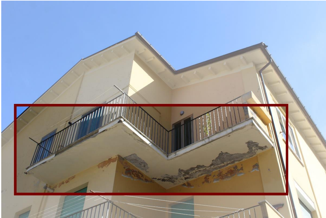
22) Inadeguato smaltimento delle acque meteoriche (balconi).
