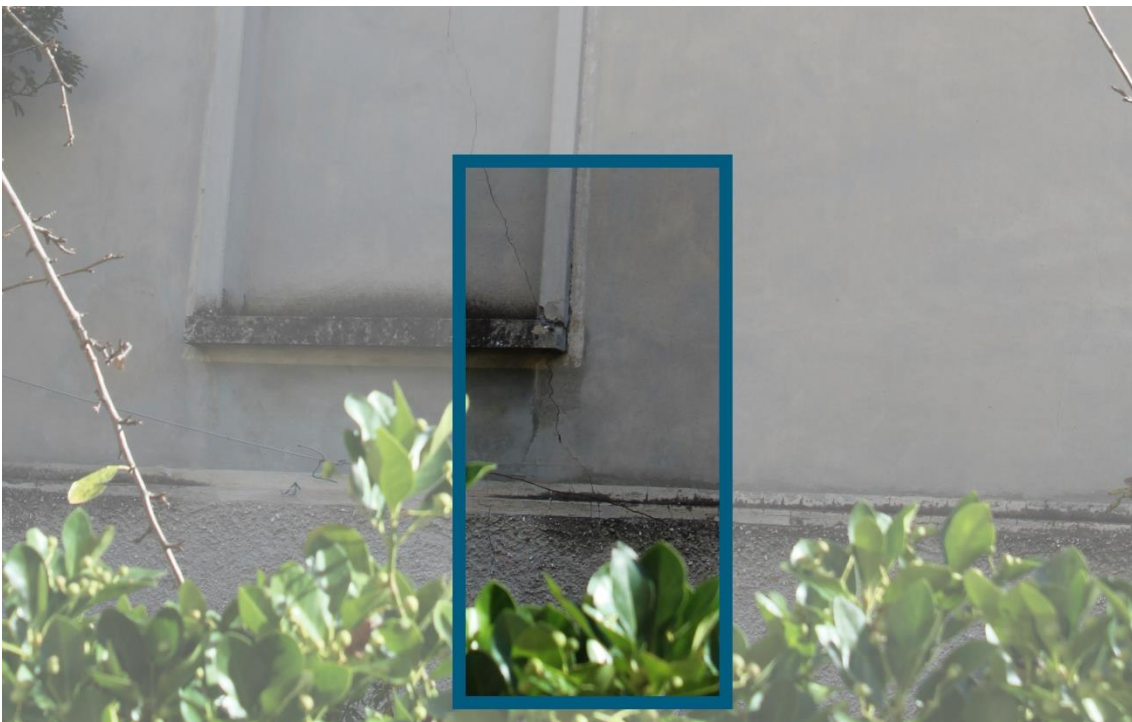
17) Lesione da traslazione verticale in un muro con aperture (percorsi che offrono la minore resistenza alla rottura).
