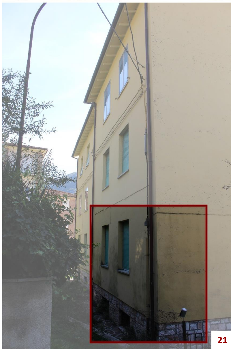
20-21) Umidità di risalita dal terreno e cristallizzazione di sali solubili.
