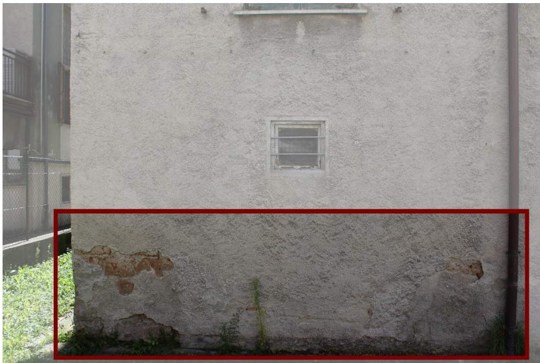
31) Umidità di risalita dal terreno con cristallizzazione di sali.
