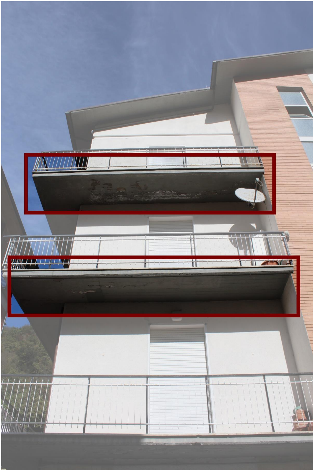
27) Inadeguato smaltimento delle acque meteoriche (balconi) e assenza di manutenzione.
