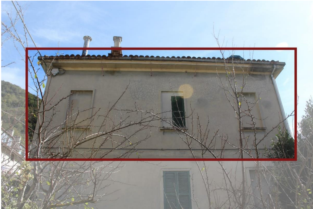
14) Inadeguato smaltimento delle acque meteoriche ed umidità di condensa con ammaloramento dell'intonaco.
