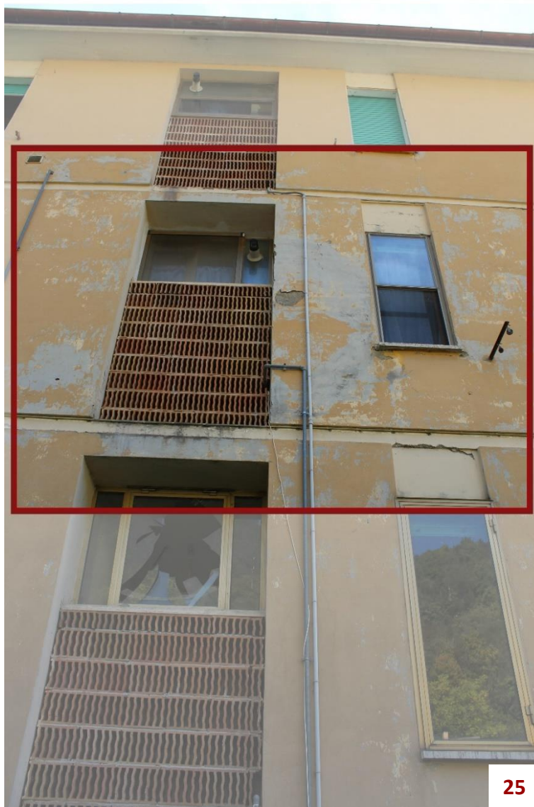
24-25) Umidità di condensa con ammaloramento dell'intonaco.
