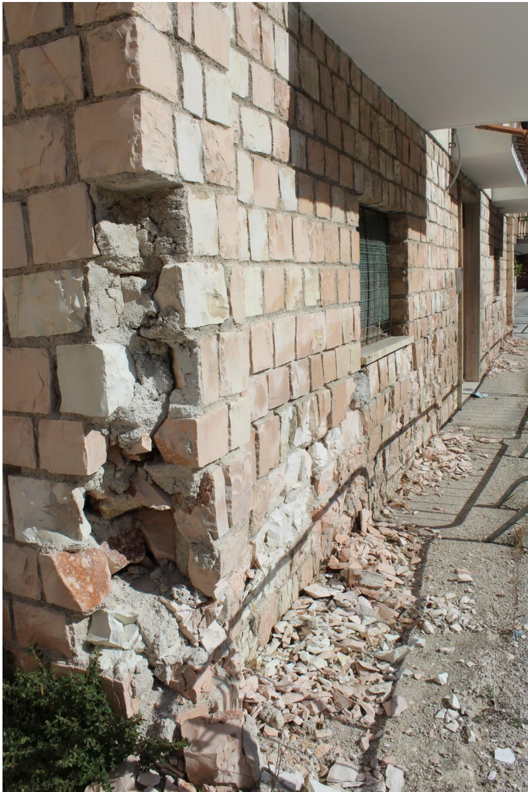
9) Lesione da traslazione verticale terminale derivante da cedimenti fondali combinata con l'azione sismica.
