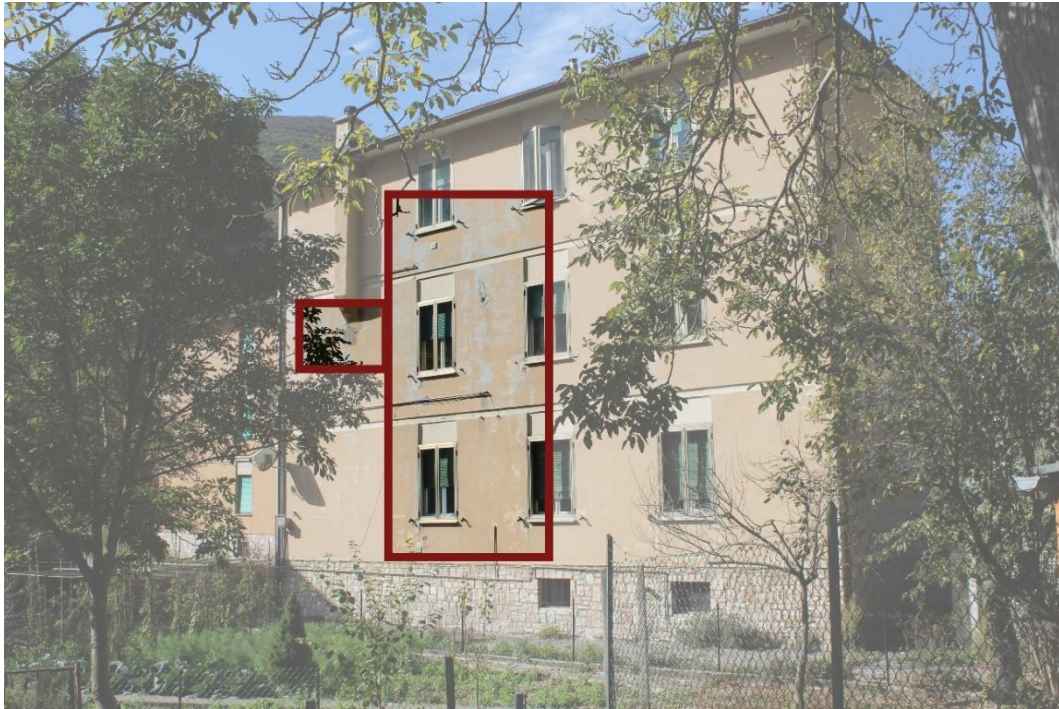
7) Umidità di condensa con ammaloramento dell'intonaco ed inadeguate disposizioni impiantistiche (degrado in corrispondenza della canna fumaria).
