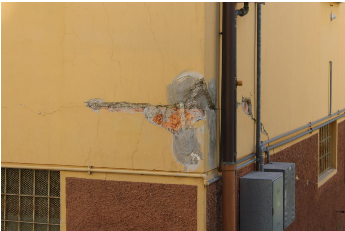
1) Lesione da traslazione orizzontale trasversale terminale - Dettaglio.
