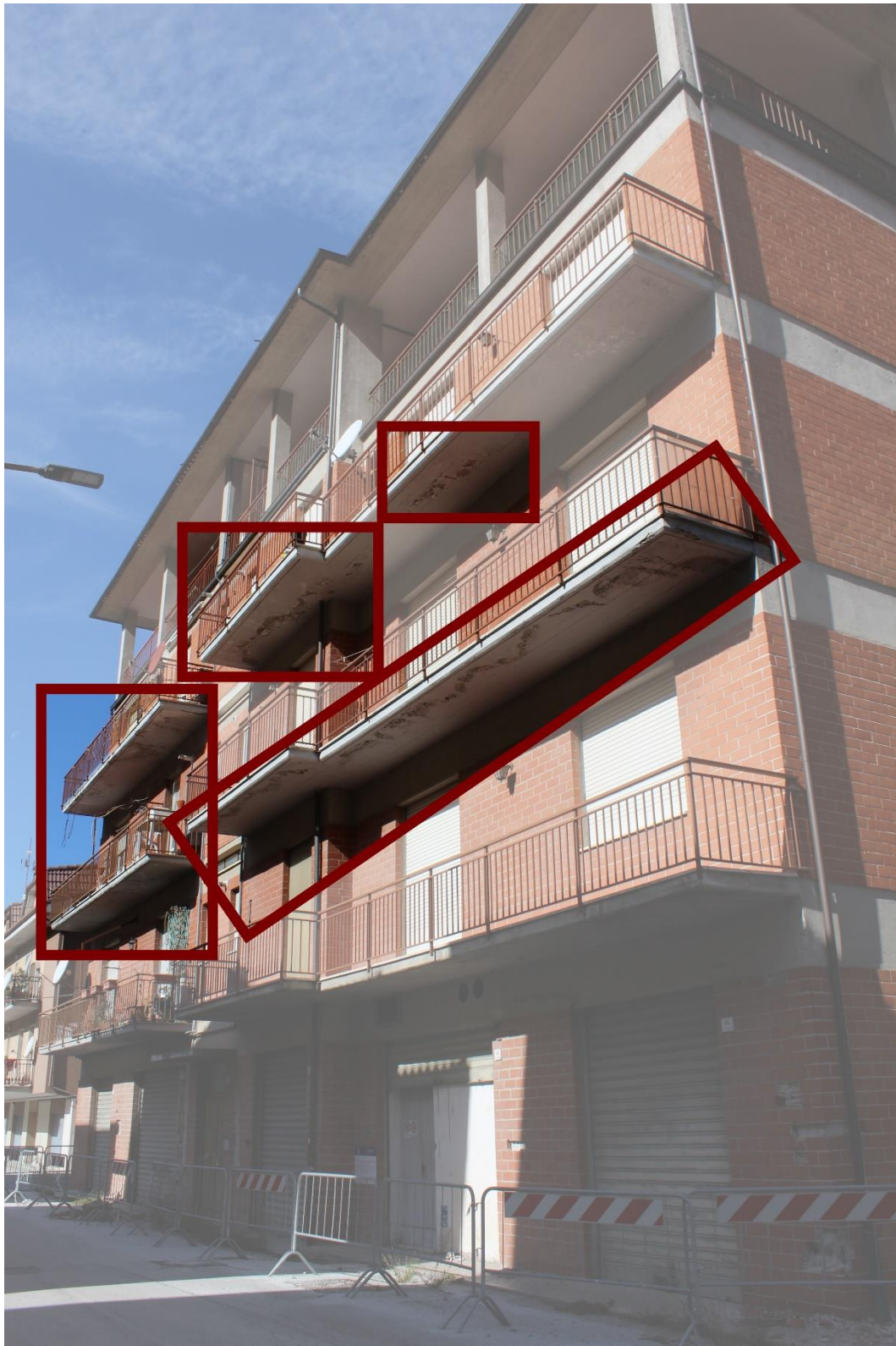
28) Inadeguato smaltimento delle acque meteoriche (balconi).
