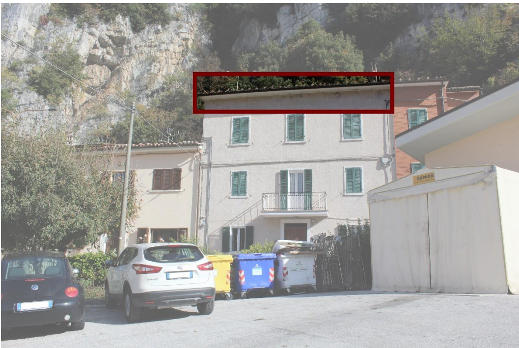
2) Inadeguato smaltimento delle acque meteoriche e scarsa manutenzione.
