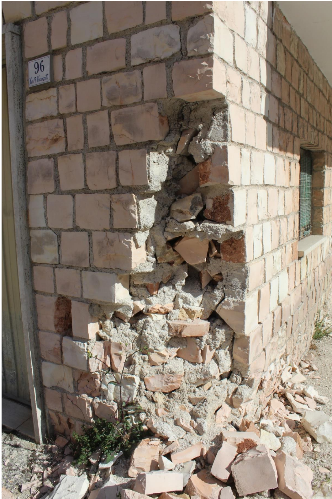
10) Lesione da traslazione verticale terminale derivante da cedimenti fondali combinata con l'azione sismica.
