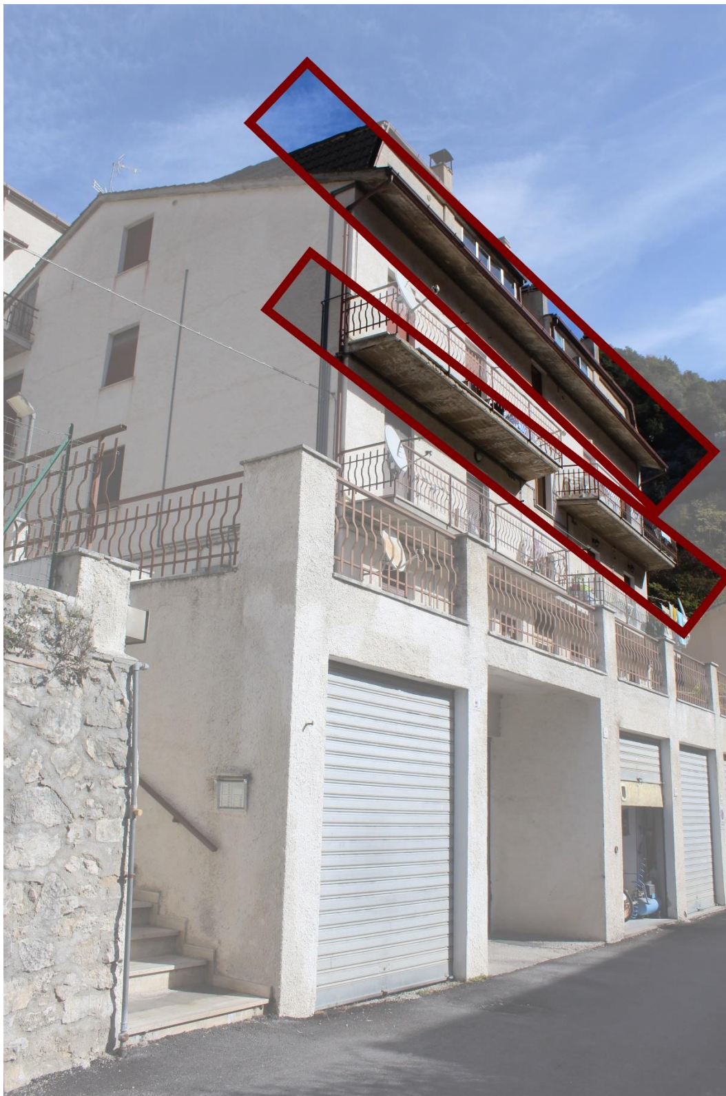
13) Inadeguato smaltimento delle acque meteoriche (balconi).
