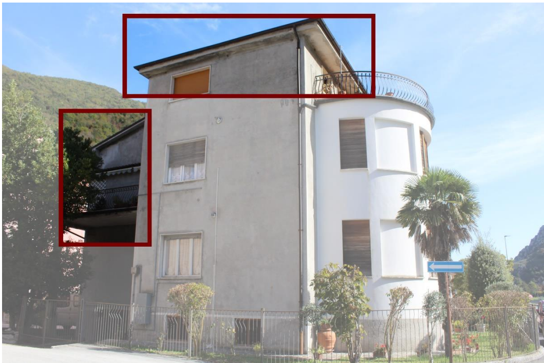
23) Inadeguato smaltimento delle acque meteoriche (balcone e cornicioni) con scarsa manutenzione.
