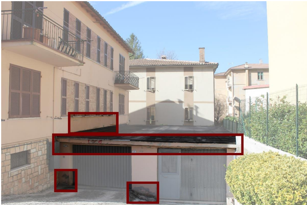
3) Inadeguato smaltimento delle acque meteoriche ed umidità di risalita dal terreno.
