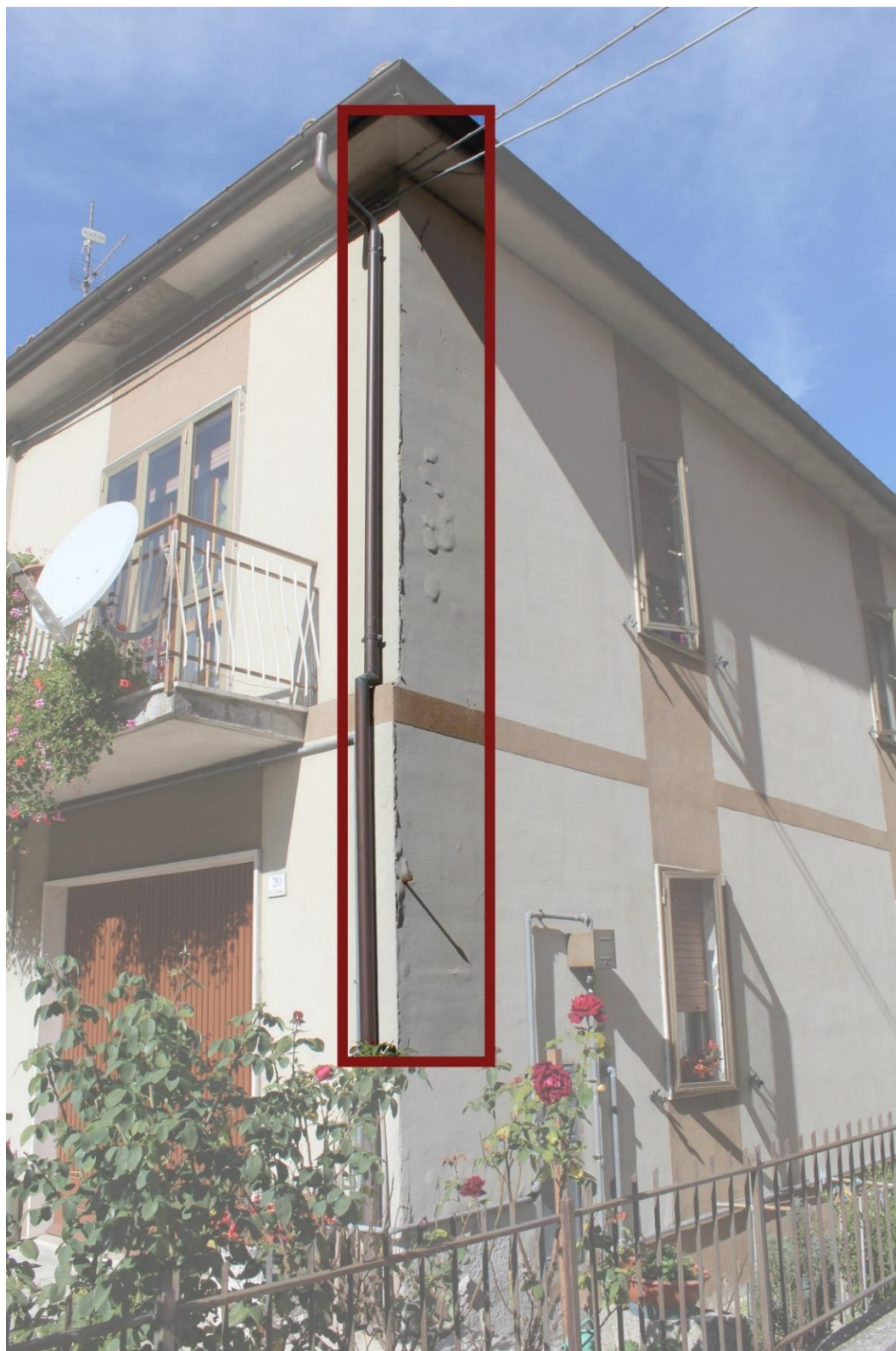
26) Umidità di condensa con ammaloramento dell'intonaco.
