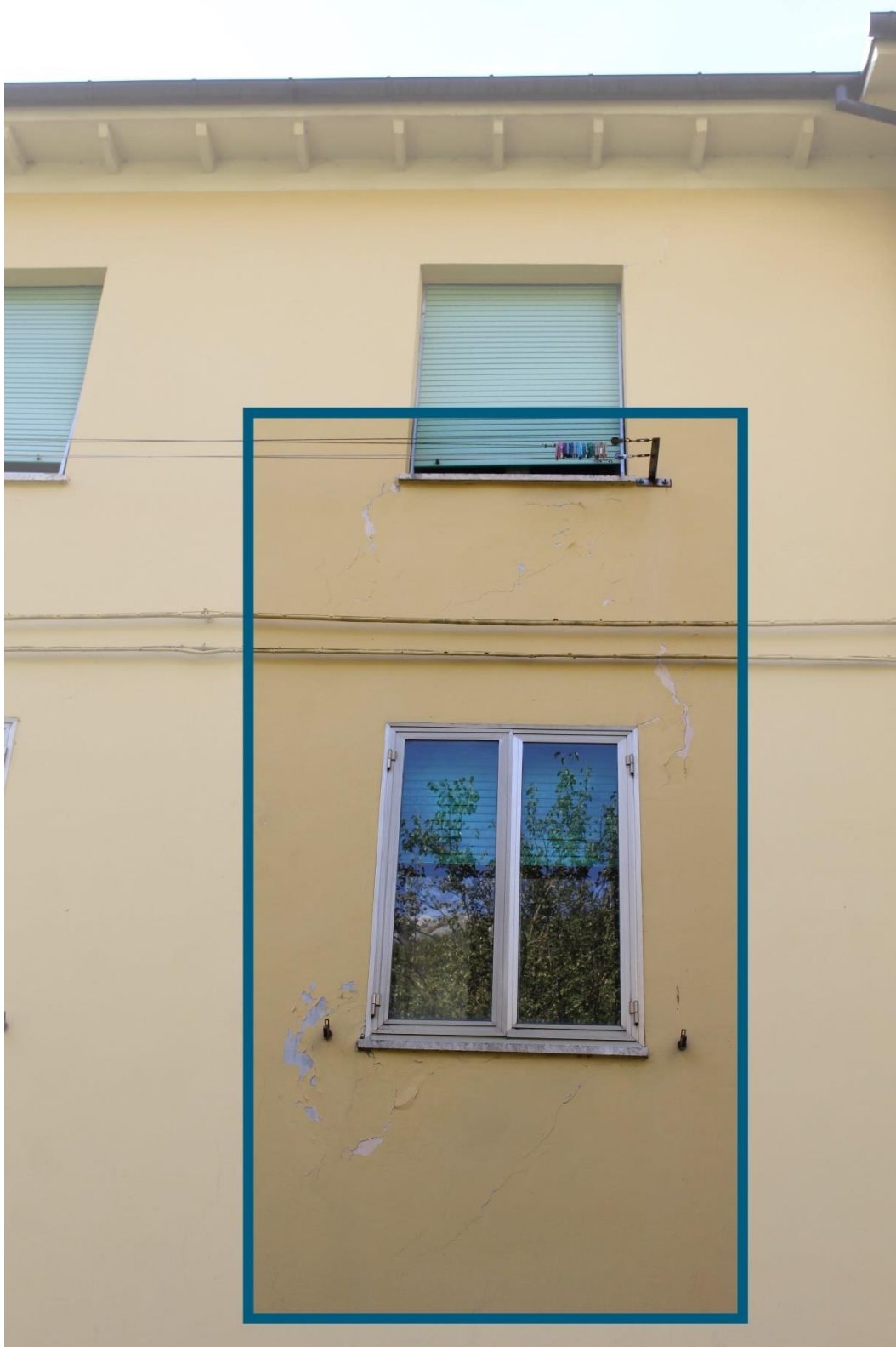
19) Lesione da traslazione verticale in un muro con aperture (percorsi che offrono la minore resistenza alla rottura).
