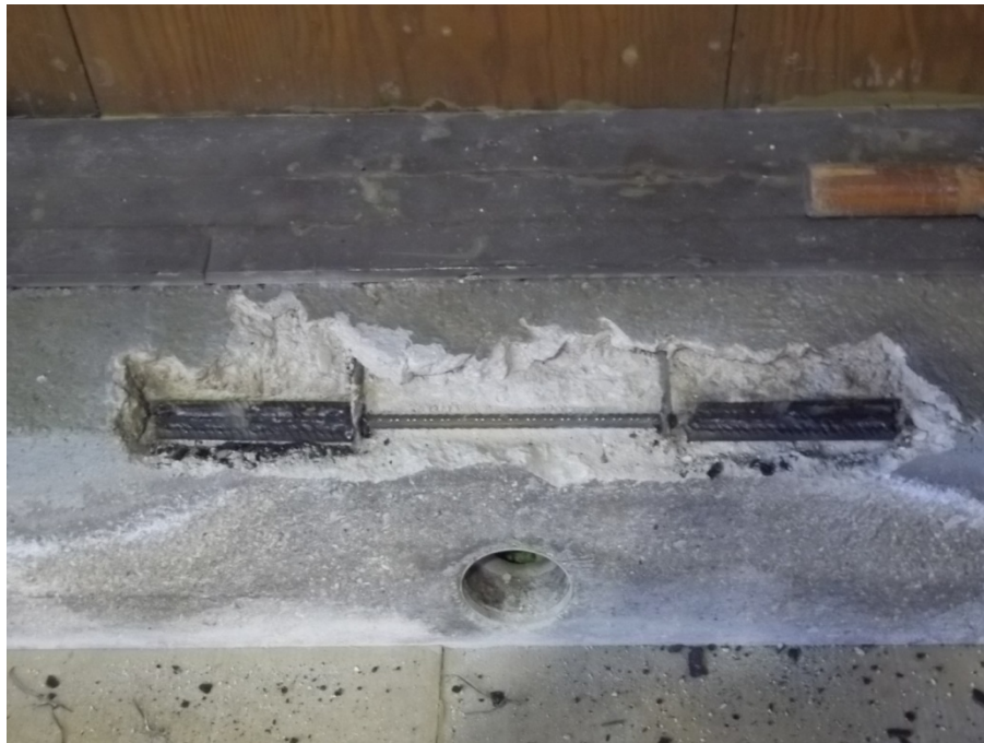
FOTO 3 – Barra di acciaio prelevata e ripristinata mediante saldatura
