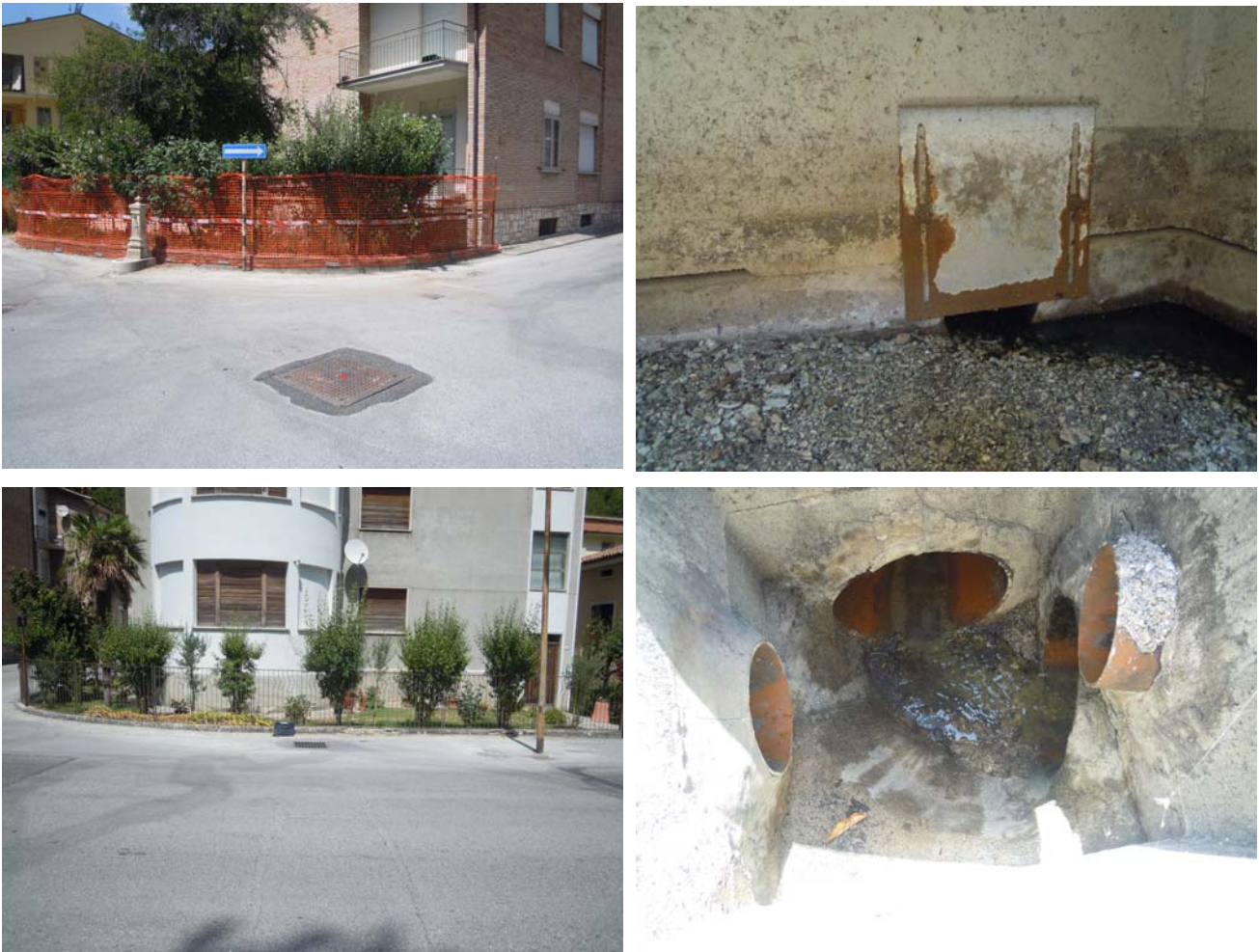
Figura 3: Pozzetti fognari all'innesto di Via della Madonnetta con Viale Raffaello Sanzio
